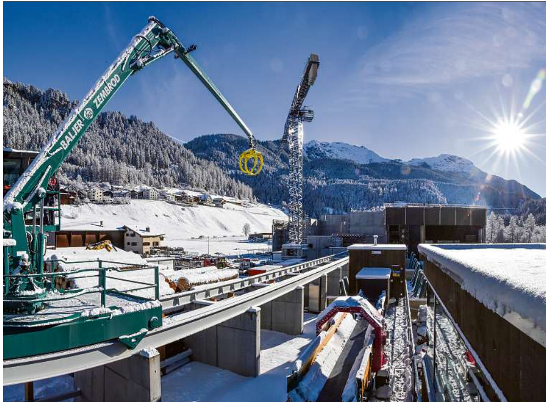
Ein Blick auf das Resurses-Initialwerk bei Tinizong: Über die Transportbänder gelangen die Rundholzstäme in die Verarbeitungshalle (hinten).
